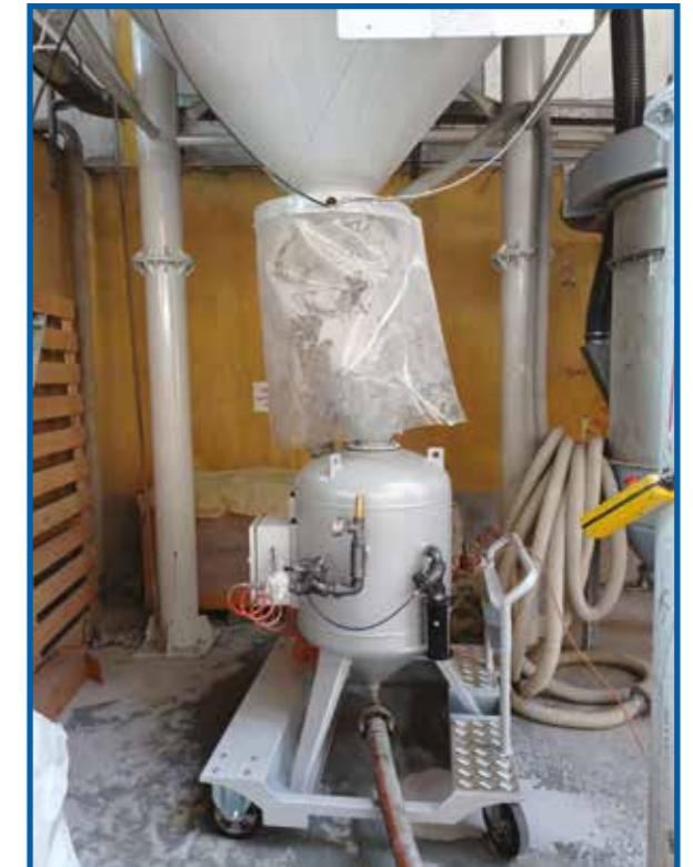
SU 200 HP sotto silo
