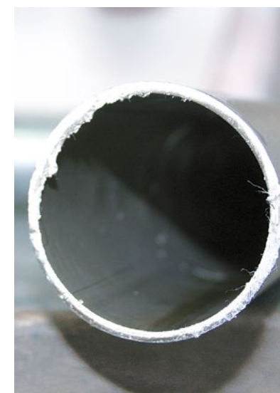
Esempio di rimozione del calcare
